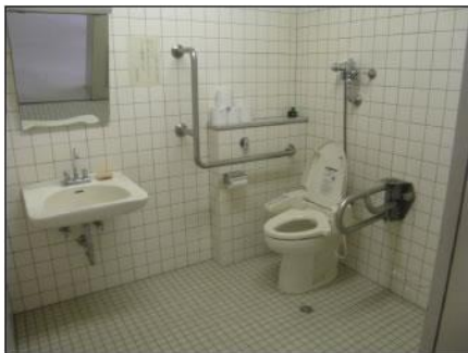
多目的トイレ例
