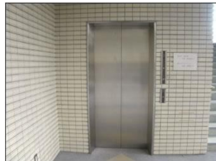
(例) エレベーター
